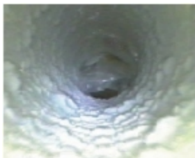
Грязный воздуховод в больнице
